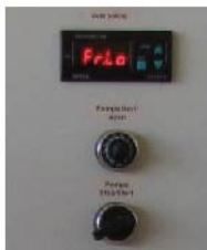
Debi ölçümü ve pompa kontrol sistemi
